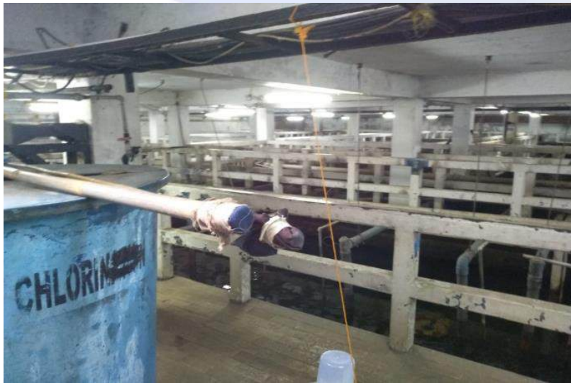
Tempat Penampungan Limbah Air
